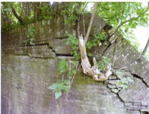
Fort bij Vechten; een voorbeeld van aangetaste muren (foto: C.G.F. Ampt)
